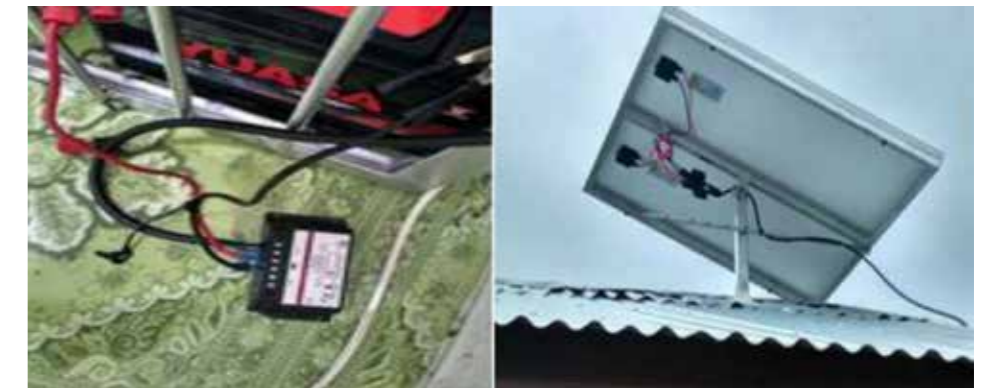
Proses pengujian PLTS dan panel surya yang terpasang
